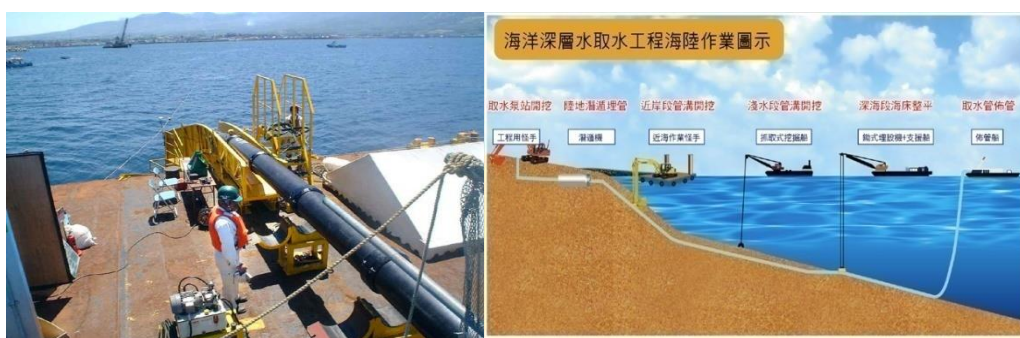
圖 25 海洋深層水佈放汲水管時的施工情形，卻遭遇強大內波全數損毀
